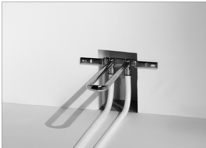
Heizkörperanschluss mit HK-Montagegarnitur – bereit zum Abdrücken
