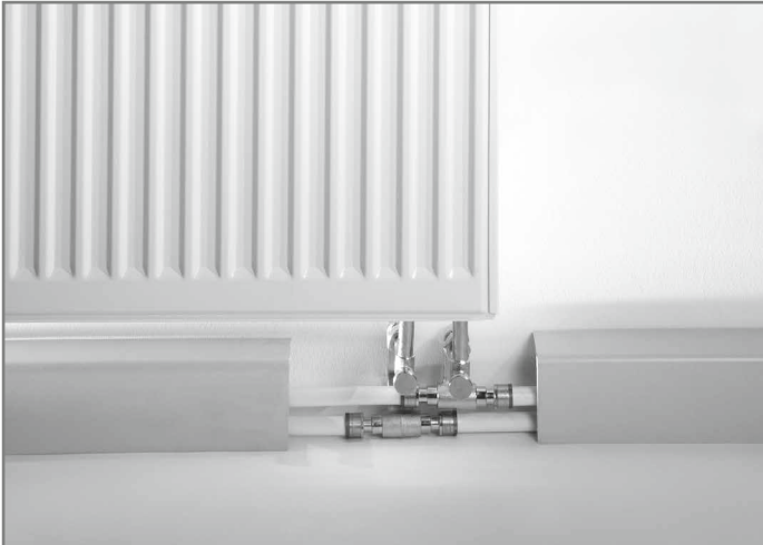
Heizkörperanschluss aus der Sockelleiste
