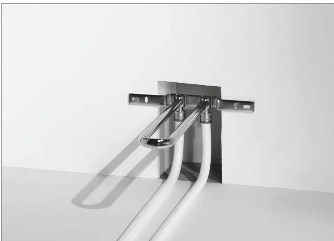
Heizkörperanschluss mit HK-Montagegarnitur – bereit zum Abdrücken
