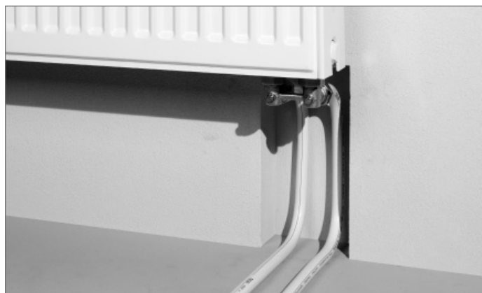
Podłączenie grzejnika ze ściany
